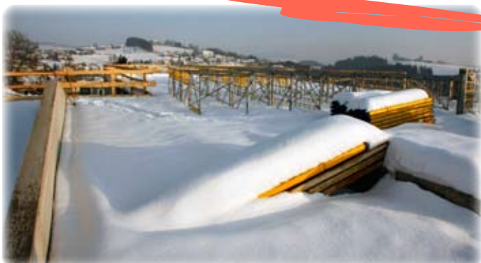
Bild unten: Schneelage auf der Decke verhindert vorerst die Montage des Daches.
